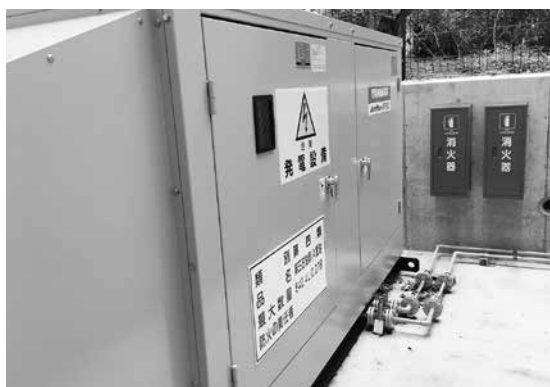
非常用予備発電装置
