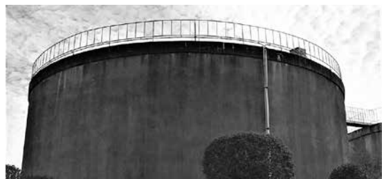
上牧町給水タンク
