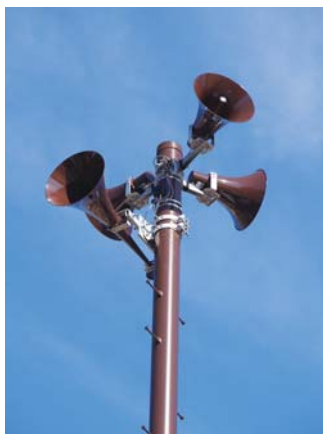
町内各所に設置されたスピーカー。 身の安全を守る必要のある災害発生時などには非常放送を行います。
