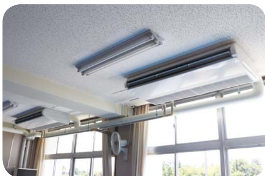
快適な学校生活が待っています!! (設置されたエアコン)
