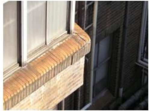
外壁に浮きが生じている
