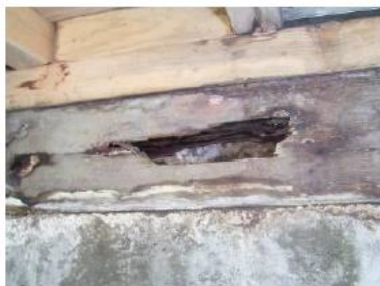
土台に蟻害が発生している
