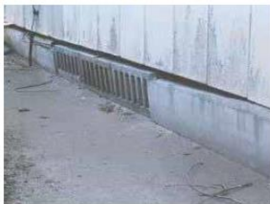
基礎が沈下し破損している
