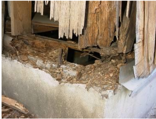
蟻害が発生し欠損している
