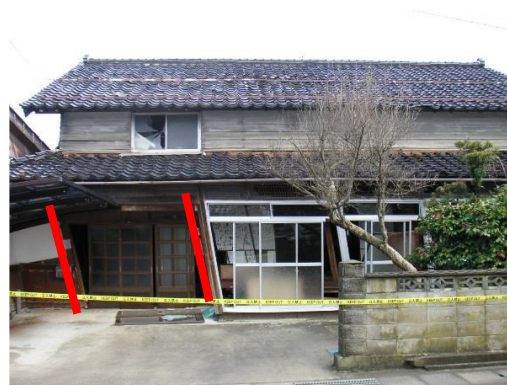
Ⅰ 階部分が傾斜している
