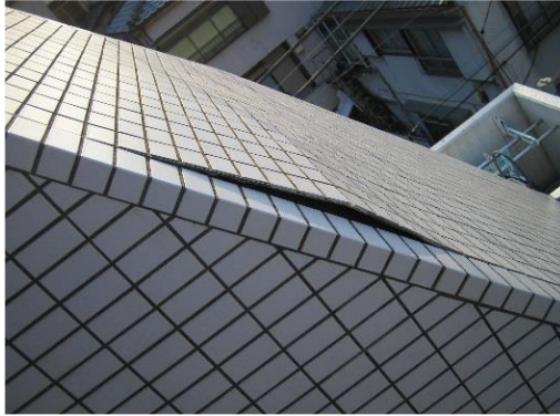
外壁に浮きが生じている
