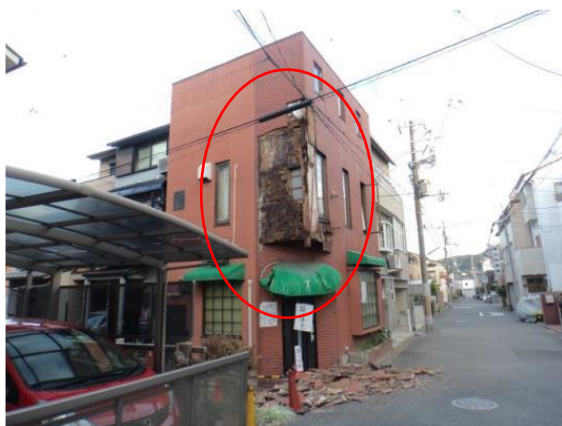
外壁が破損している
