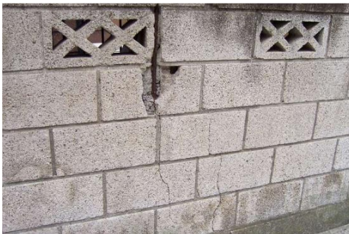
塀に大きなひび割れが生じている
