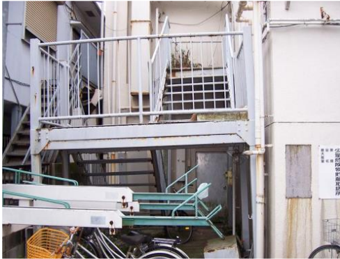
屋外階段が傾斜している
