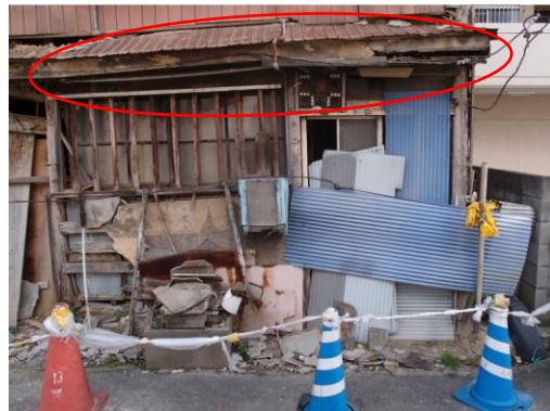
軒に不陸、剥離が生じている
