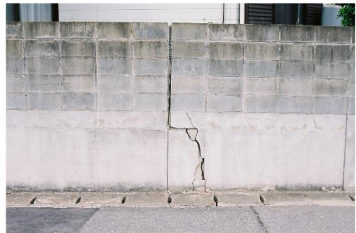
塀に大きなひび割れが生じている
