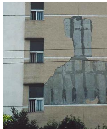
外壁に脱落が生じている
